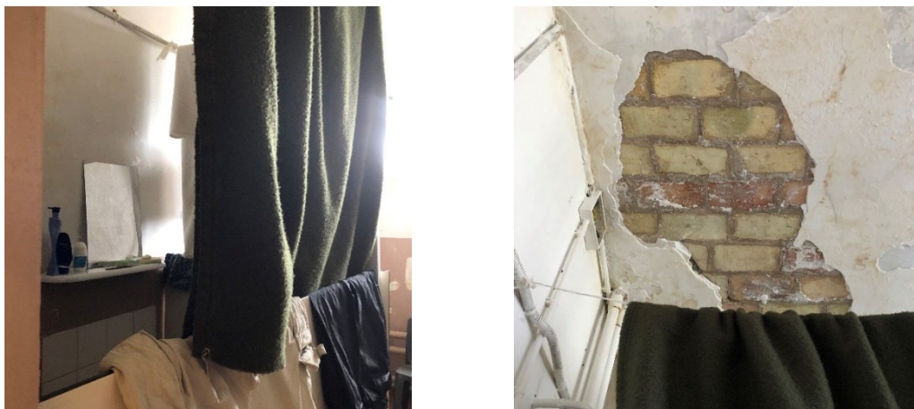
Dans une cellule : l'espace sanitaire sans parois de séparation avec le plafond qui s'effondre au-dessus des toilettes
