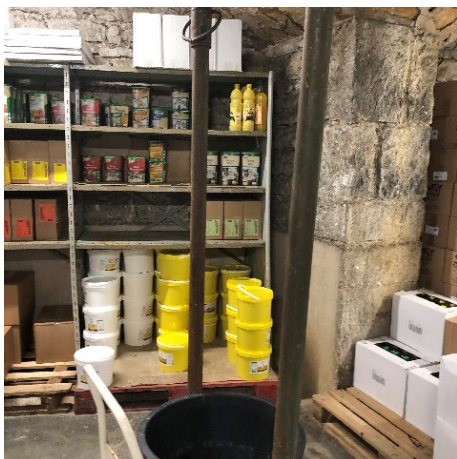
Fuite d'eau dans la réserve alimentaire
